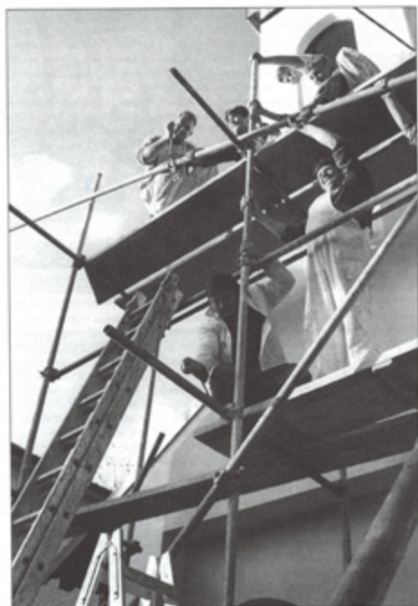
Završni radovi priklonke izgradnje novog tornja na kapelici u Donjlovcu, u izvođenju Marijana Goričaja, subodlikarskog majstora iz Donjlovcu (1997.)
