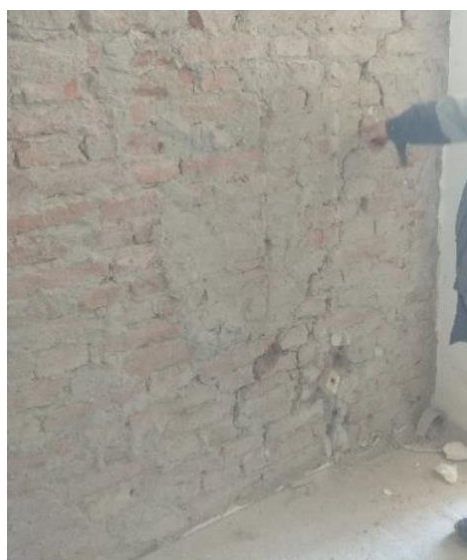
Pukotine širine veće od 10 mm
